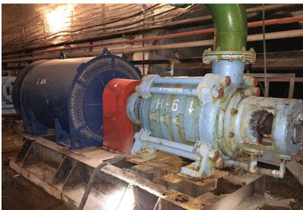
Рис. 4.10. Водовідливний агрегат з насосом ЦНС-300/440 та електричним двигуном напругою 6000 В
