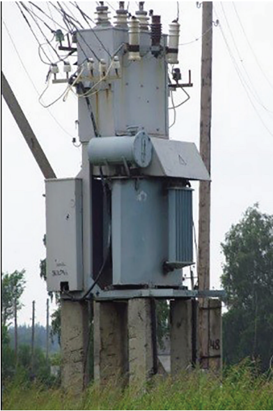
Рис. 4.21. Загальний вигляд КТП 10/0,4 кВ
